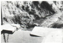
Une vanne simple, gardée par une chaîne, à St Dizier.
