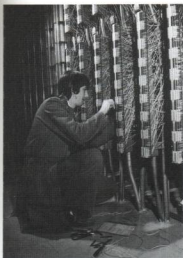
Répartiteur dans un central, arrivée extérieure
