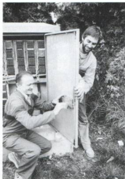
Armoire de sous-répartition
